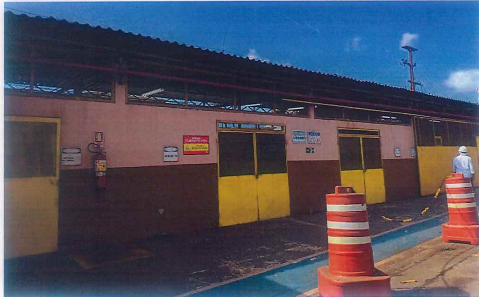
Imagem 13: Casa de Máquinas
